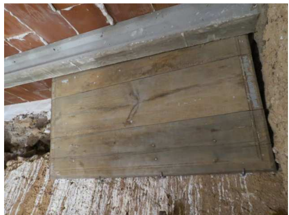
29.09.2015 Fusta recolzada als tres claus de ganxo impedint la visió de la caixa niu.
